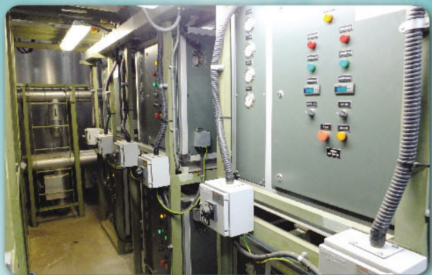
▲廣華醫院利用熱泵技術產生熱水，能源效益遠勝直接加熱，節省電能。
